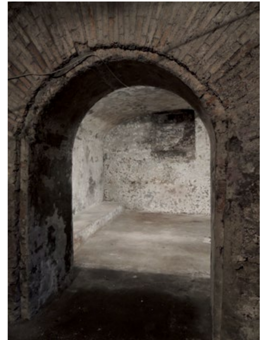
In queste pagine, il piano interrato di Palazzo Carpegna dopo lo sgombero dei materiali di risulta condotto nel luglio 2011.
